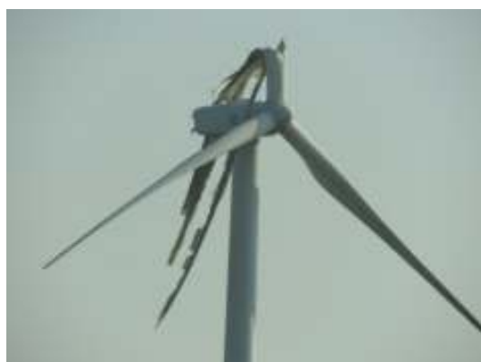
(c) 落雷による損傷が拡大し折損したブレード(No. 9, 10)
