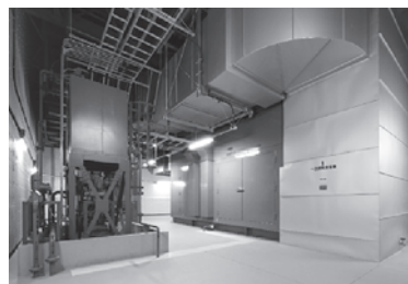
図表2. 自家発電設備の例
