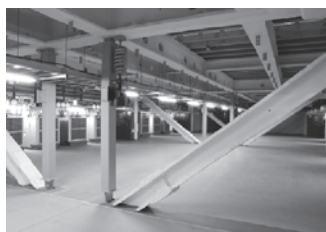
(c) 縦揺れ制震ダンパー
