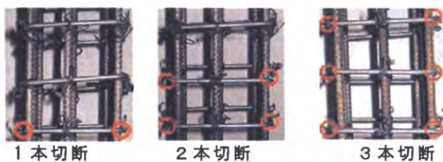
図 2 帯鉄筋切断状況
