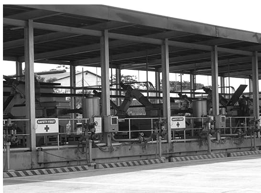
Photo 2 最新鋭の全自動下水処理施設（マニラ）
