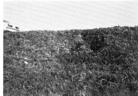
(d) 雨水の集中によるのり面浸食と浸透の形跡
